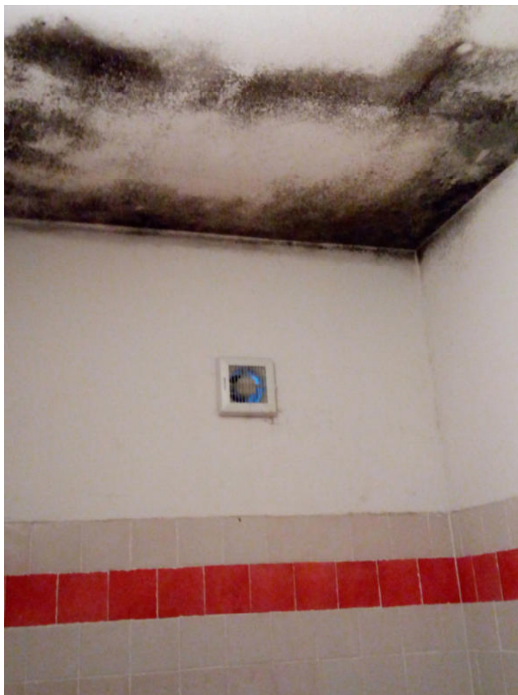
Foto 32: Vista wc con gravosi ammaloramenti - P.1°
