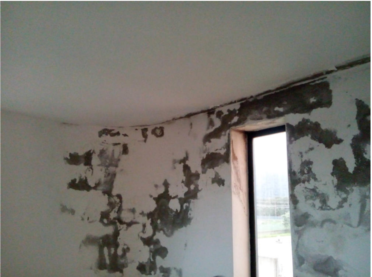
Foto 8: Vano scala con importanti ammaloramenti
