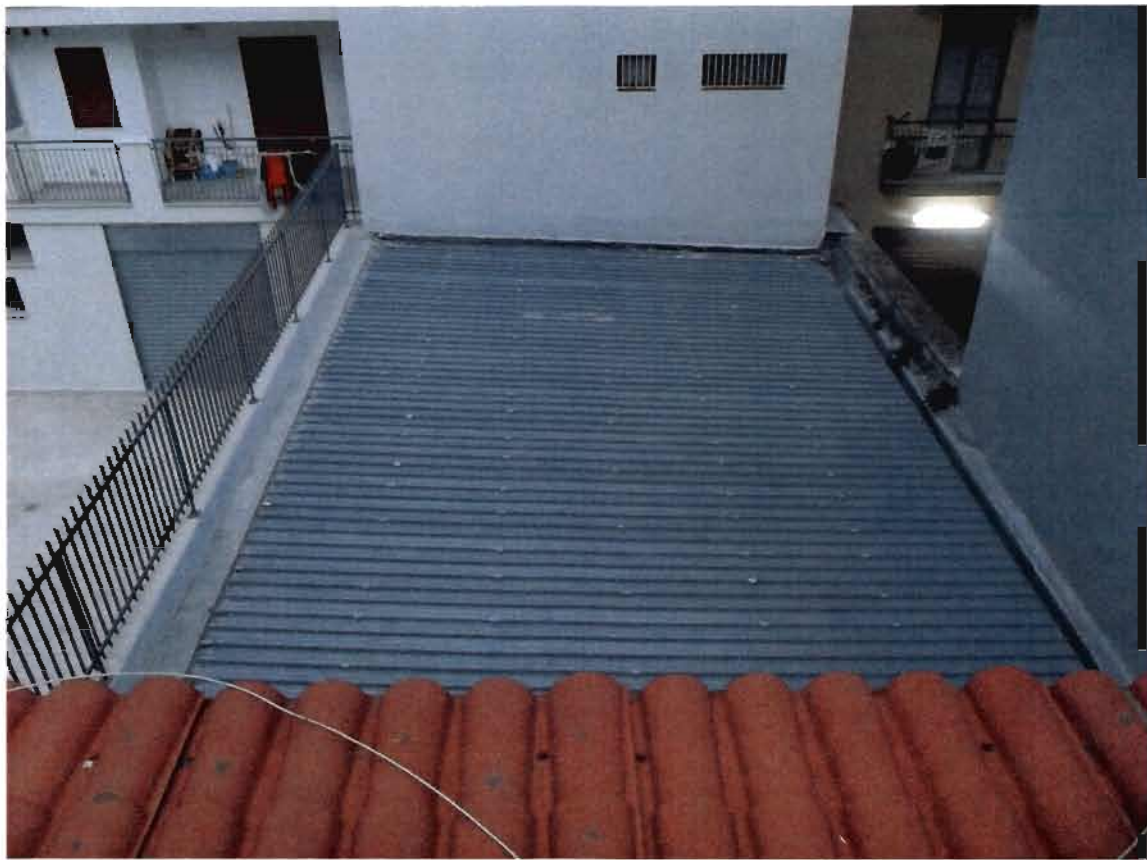
Foto 69. Barletta. Via Solferino, 20. Affaccio area interna. Copertura piano terra - vano retrostante.
