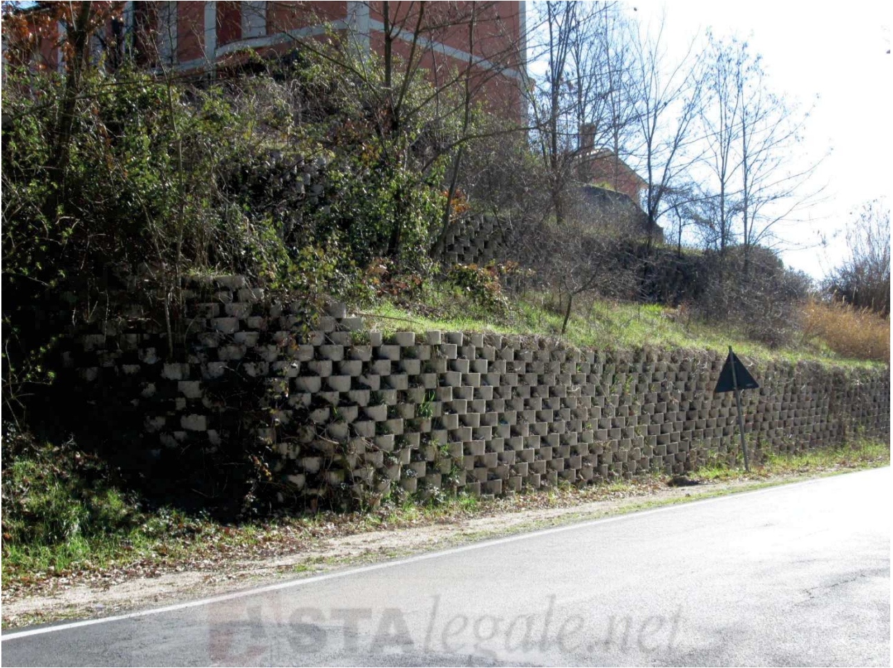
Particolare muro di contenimento del terreno lungo la strada denominata "Cà Guerra" e realizzato con grigliati inerbiti
