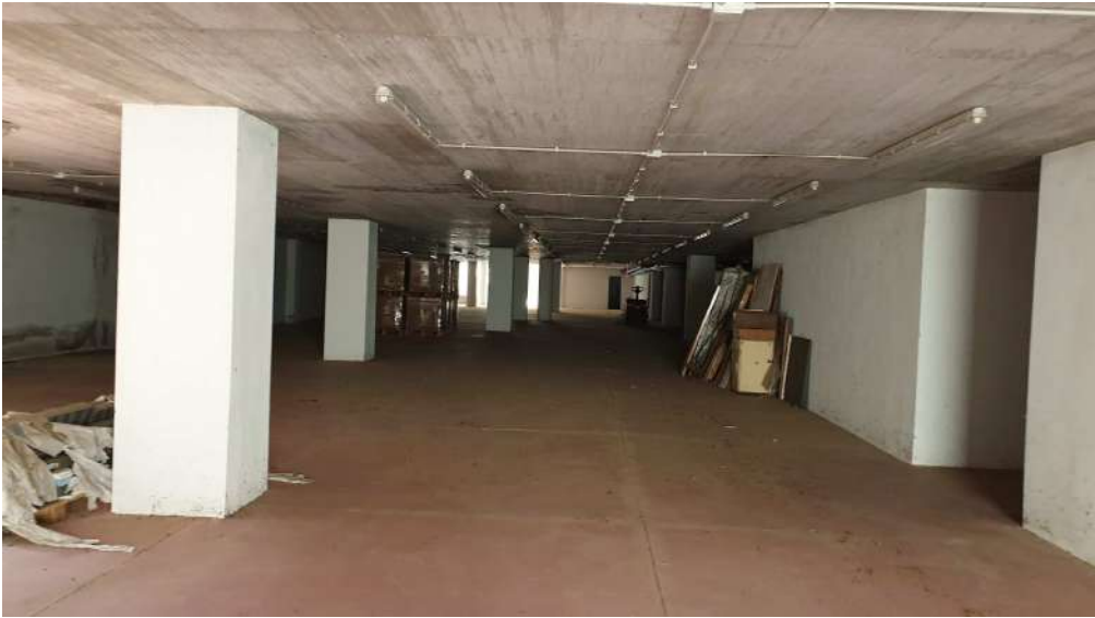
EDIFICIO B: foto interne piano S1
