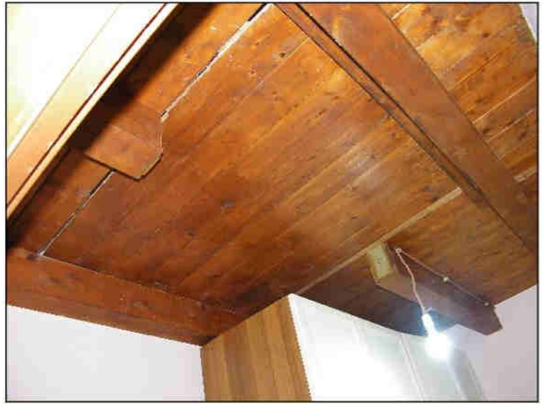
Foto 23. Botola di accesso al sottotetto
