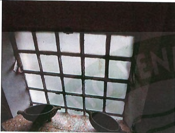
degrado finestrini vano scala
