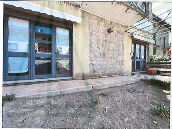
annerimenti nell'intradosso della soletta dei balconi
