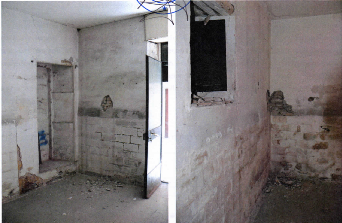
Vista interna del locale – condizioni della muratura
